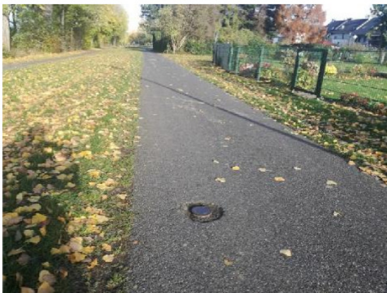
Foto 09: Der Radweg in der Rheinaue ist zu schmal und stellenweise schadhaft.
