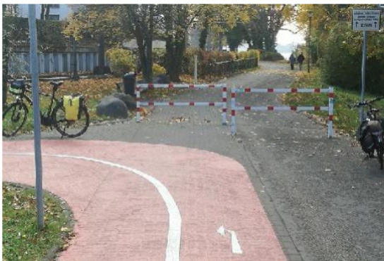
Foto 23: Am Knotenpunkt zur Umfahrroute (6) muss die Geradeausfahrt gestattet und die Umlaufsperrung entfernt werden; weitere Verbesserung der Sichtbeziehungen. Der rote Belag, der bei Nässe schon zu Unfällen durch Ausgleiten geführt hat, ist zu entfernen.
